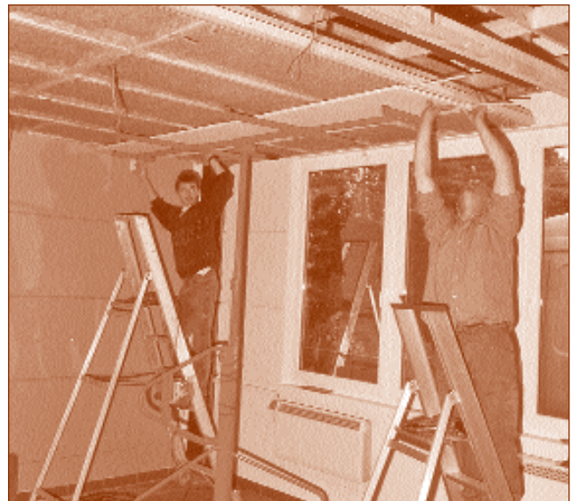
Plafondverwarming bij verlaagde plafondconstructie.
